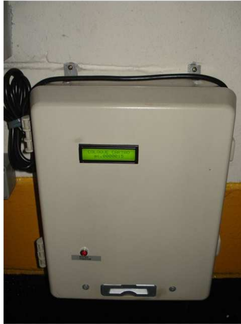
Fig. 4.6: Medidor Pré-Pago instalado na Eletropaulo.
