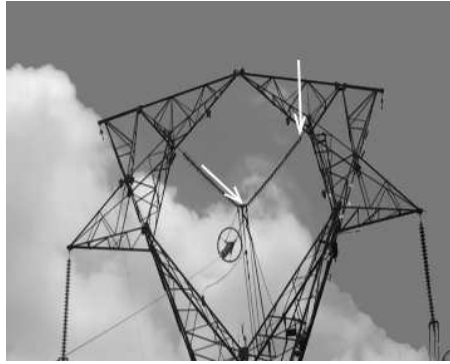
Figura 7.2: Detalhe de uma torre de alta tensão destacando as extremidades da cadeia de isoladores.
