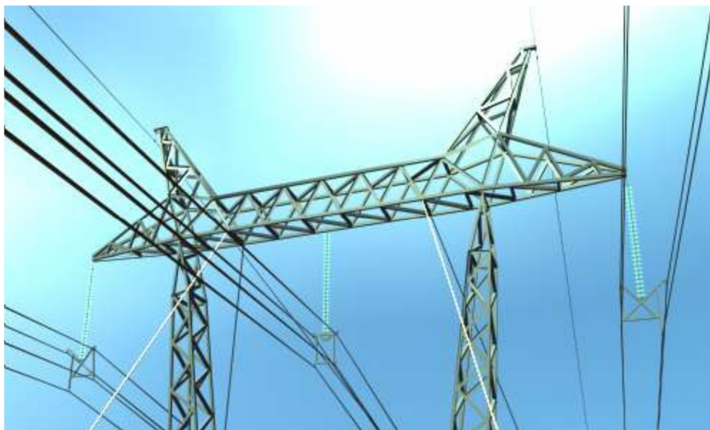
Figura 2.2. Linha de transmissão com potencial naturalmente elevado (condutores múltiplos assimétricos).
