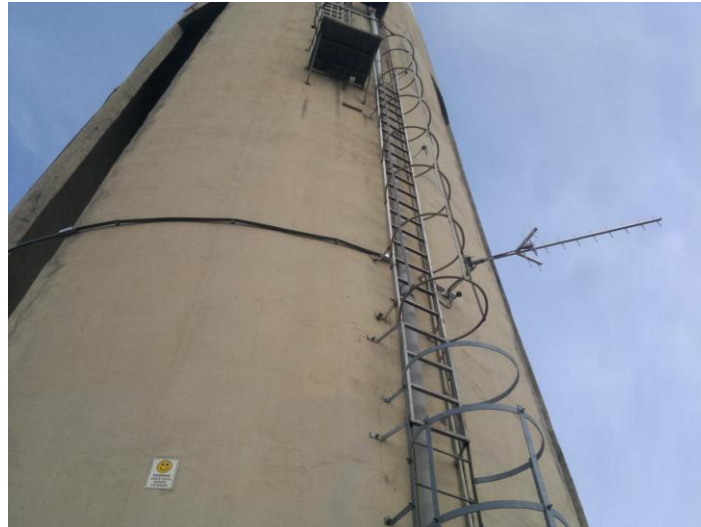
Figura 2.24 Antena de Recepção utilizando barreira física
