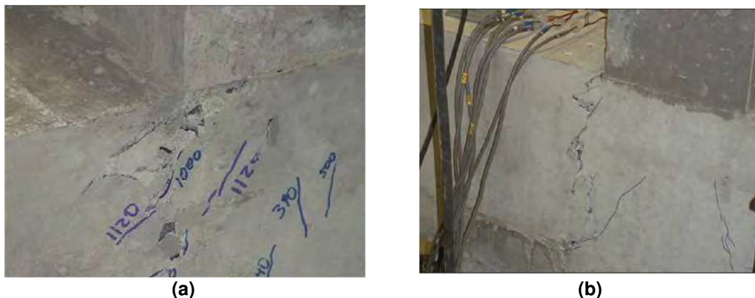
Figura 50 – (a) Ruptura do concreto junto ao pilar; (b) Ruptura ao longo da altura do bloco (Delalibera, 2006)
