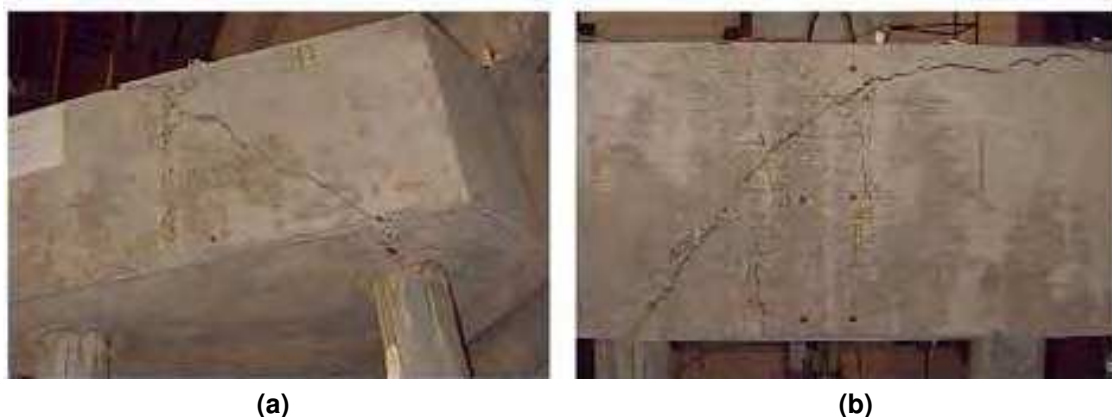
Figura 4 – (a) Vista inferior de ruptura de bloco sobre três estacas; (b) Vista frontal de ruptura de bloco sobre três estacas (Miguel, 2000)
