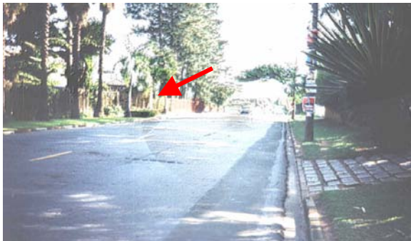
Figura 3.4: Gramas e pedras em ambos os lados, sendo agravado o do lado esquerdo pela existência de avanço do jardim
