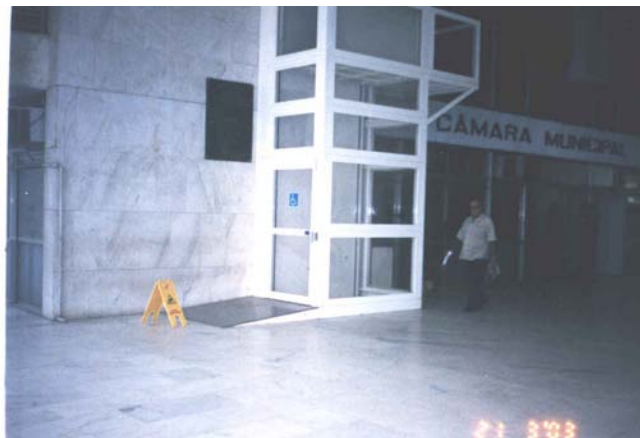
Figura 3.1 - Elevador para acesso ao plenário da Câmara Municipal de Campinas. Rampa e porta inadequadas para acesso independente da ppd usuária de cadeiras de rodas.
