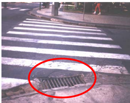
Figura 3.10: Boca de lobo em uma faixa de pedestre. Em períodos de chuva, a água se concentra nas duas extremidades da boca de lobo, em função da declividade proposital para coleta dessas águas, dificulta ou até impede a travessia de deficientes principalmente cadeirantes.
