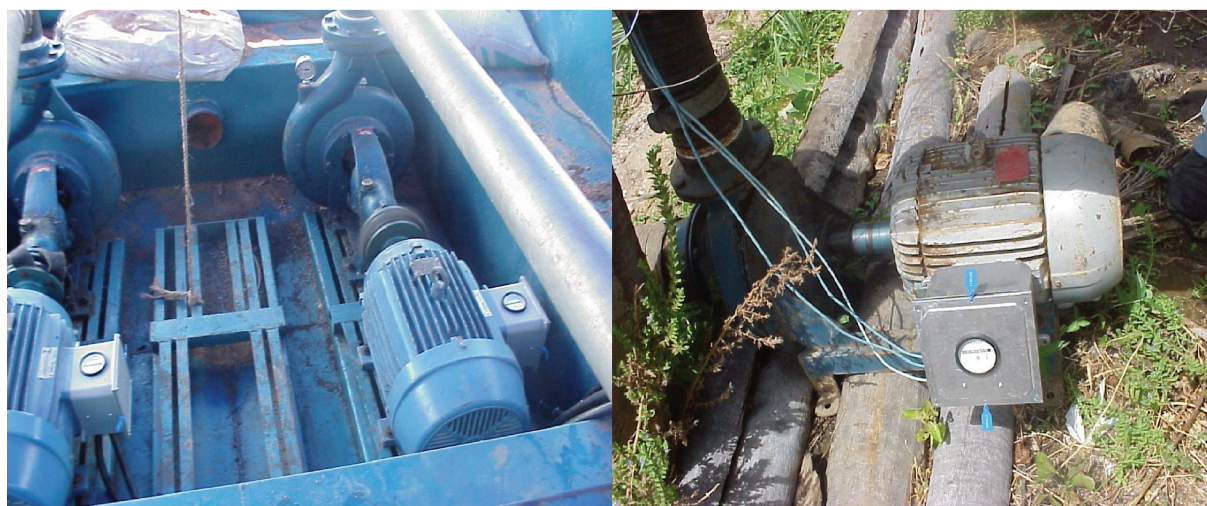
Figura 24 - Instalação típica de horímetros em bombas
