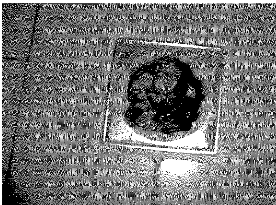
Figura 5.83: Caixa sifonada com acúmulo de gordura – CEMEI 44
