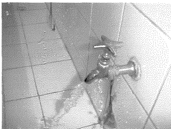
Figura 5.97: Vazamento na haste de torneira, manifestado apenas durante a utilização.
