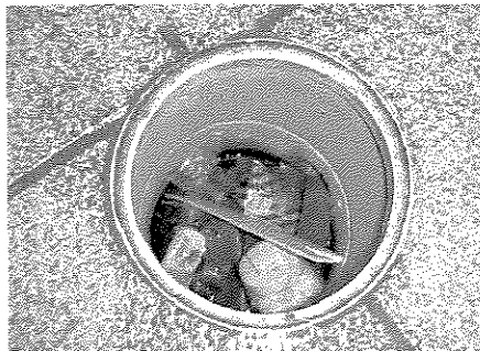
Caixa sifonada com lixo no interior EMEF/Supletivo 58
