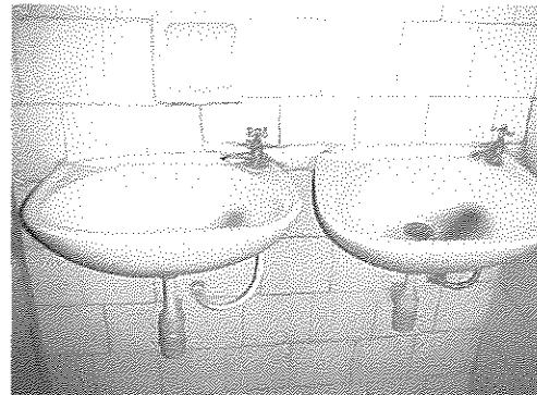
Lavatórios manchados – EMEI 144
