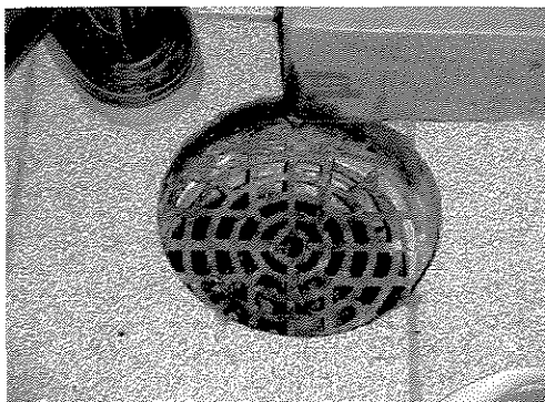
Grelha posicionada abaixo do nível do piso - EMEF 71
