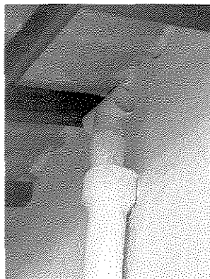
Tubulação de ventilação com a extremidade terminando antes do telhado EMEI 112
