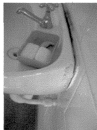
Lavatório solto - EMEI 112
