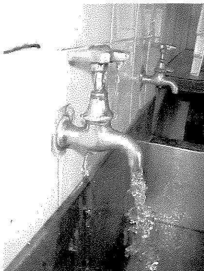
Figura 5.71: Torneira de lavatório tipo calha vazando na haste quando aberta EMEI 142
