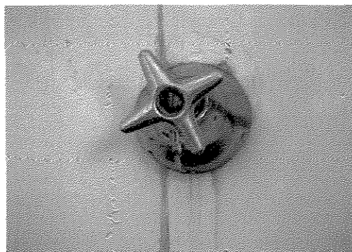
Registro com gotejamento - CEMEI/EMEI 30
