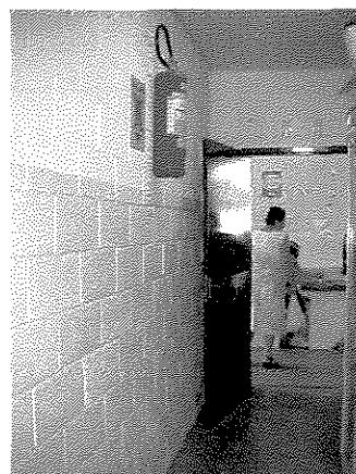
Extintor com sinalização e instalação inadequada - EMEF/Supletivo 69
