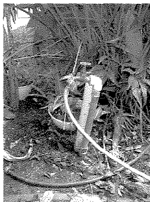
Torneira apoiada em tubulação exposta CEMEI/EMEI 35
