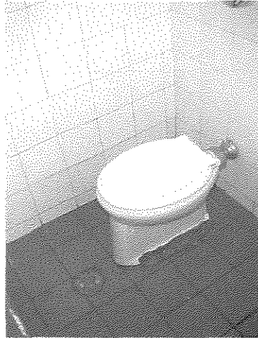
Figura 5.51: Bacia quebrada e reparada com massa epóxi - EMEI 112
