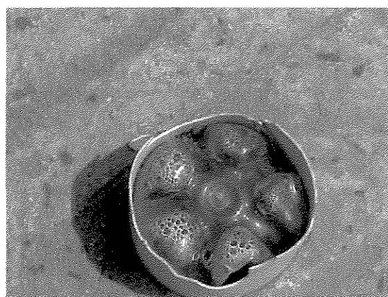
Ponto de inspeção com tampa improvisada
