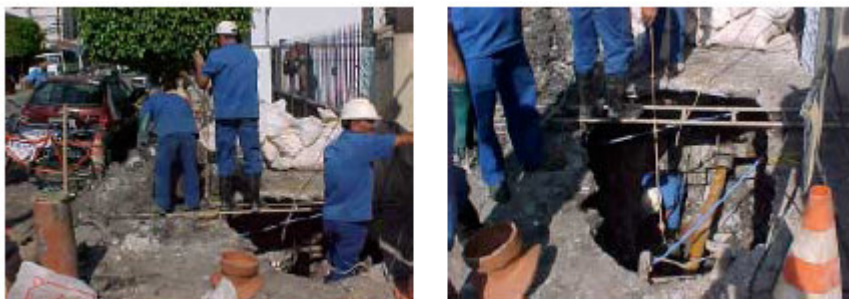
Figura C.9 - Procedimento inadequado de serviços em valas – adaptado MTE 2003
