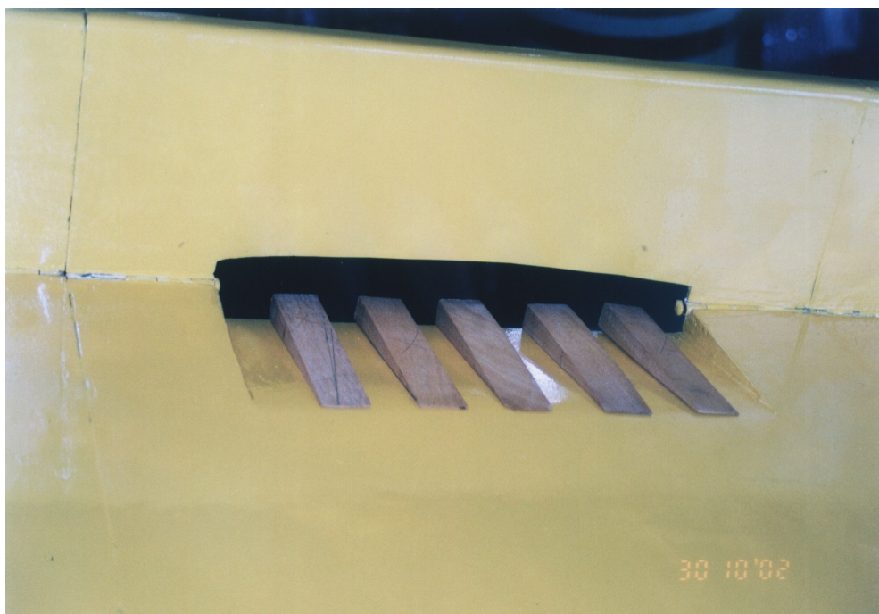
Figura 6.10. Defletores instalados na boca-de-lobo.
