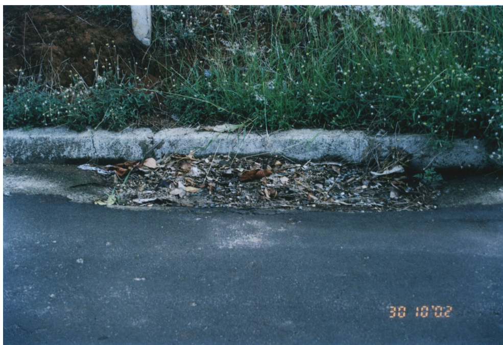
Figura 5.17. Boca-de-lobo com grade totalmente entupida. Estrutura localizada na cidade de Campinas/SP.
