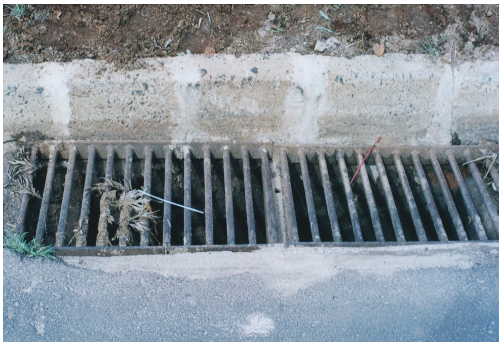
Figura 5.21. Boca-de-lobo múltipla com grade. Estrutura localizada na cidade de Limeira/SP.
