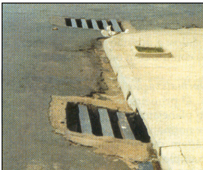
Figura 5.2. Boca-de-lobo com grelha em trilhos.
