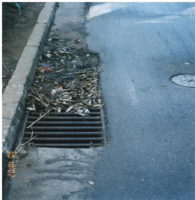
Figura 5.20. Boca-de-lobo múltipla com grade – Devido ao recapeamento. Estrutura localizada na cidade de Campinas/SP.
