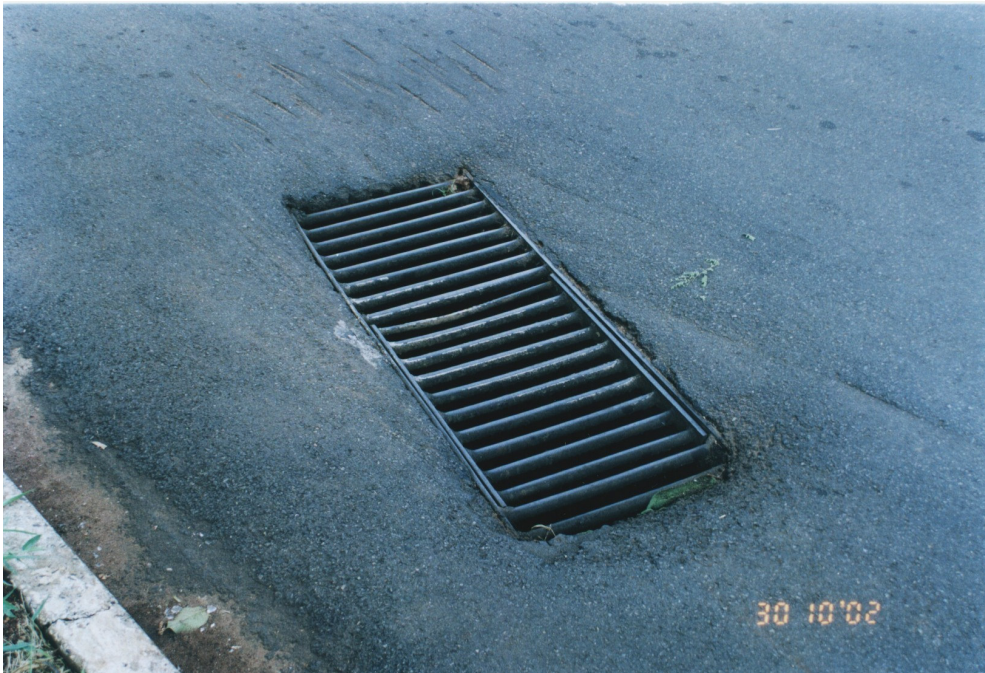
Figura 5.18. Boca-de-lobo com grade que apresenta problema devido ao recapeamento. Estrutura localizada na cidade de Campinas/SP.
