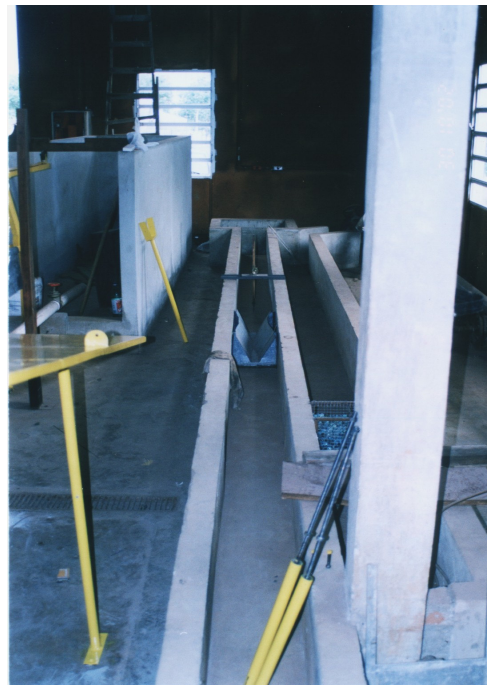
Figura 6.6. Canal de alvenaria com calha Parshall instalada.
