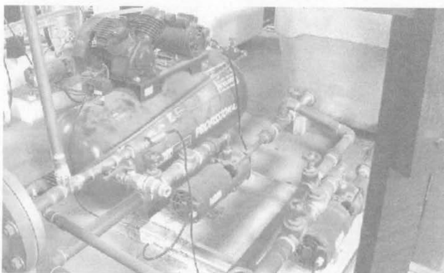
Figura 4.7 - Conjunto moto-bomba e compressor de ar.
