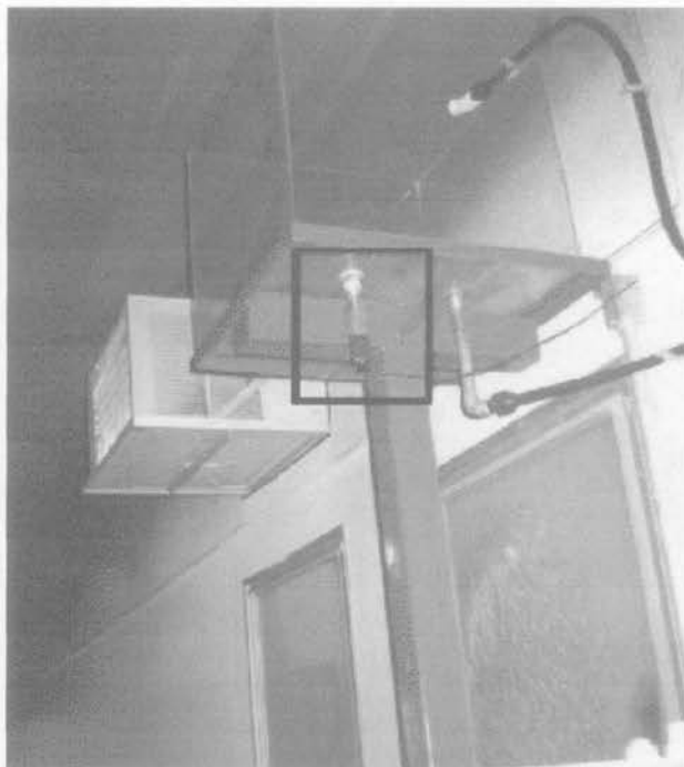
Figura 4.20 - Detalhe do medidor de nível.
