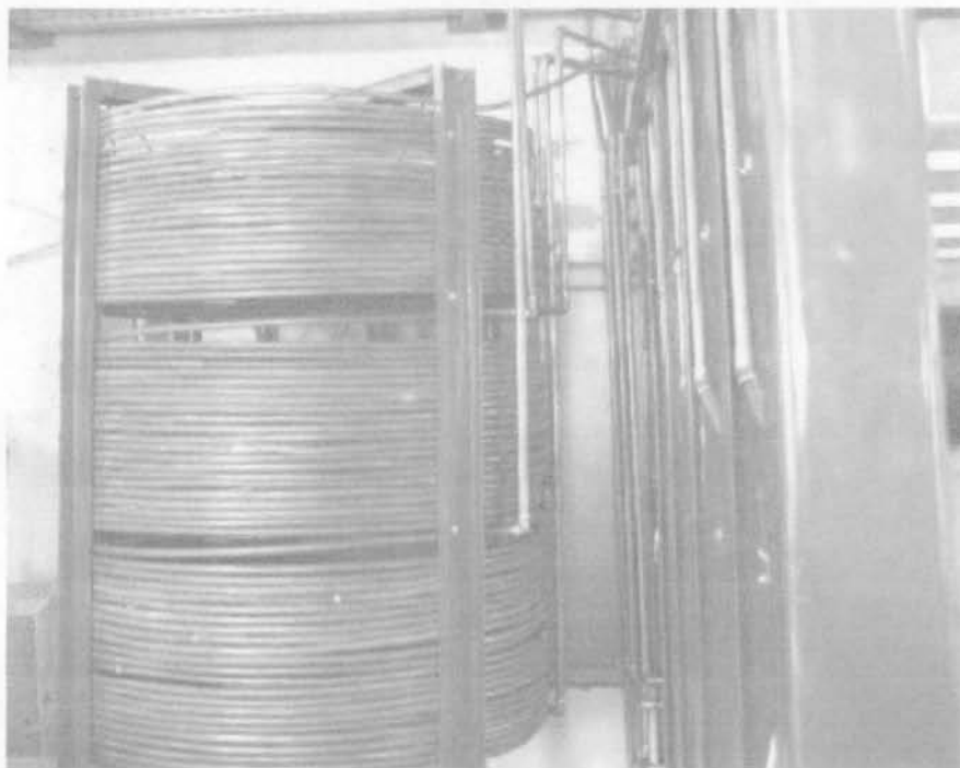
Figura 4.9 – Tubulação de cobre em formato em hélice.
