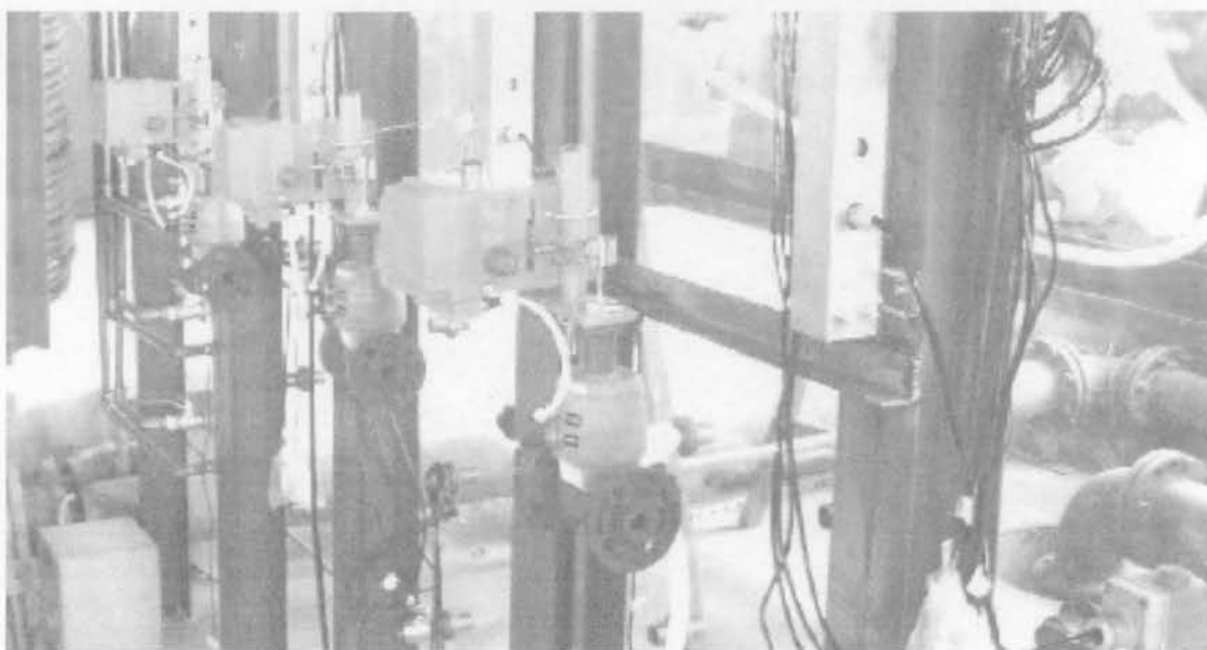
Figura 4.16 - Válvulas de controle automáticas.
