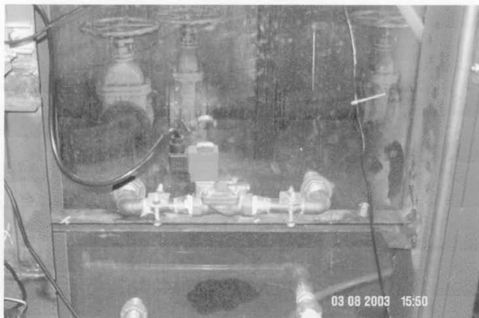
Figura 4.15 - Detalhe da válvula solenóide.
