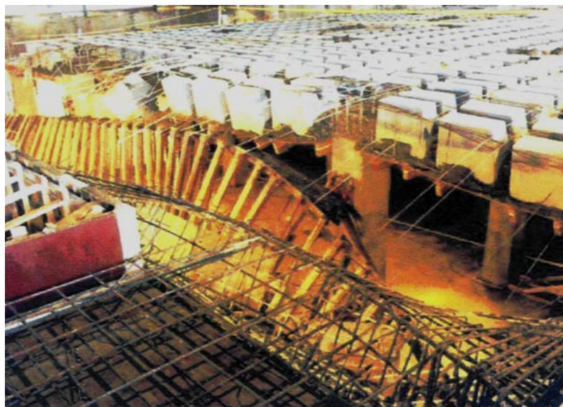
Figura 3.1.3 - Colapso parcial do sistema de fôrmas. (Fonte: Zallen Engineering, 2002).
