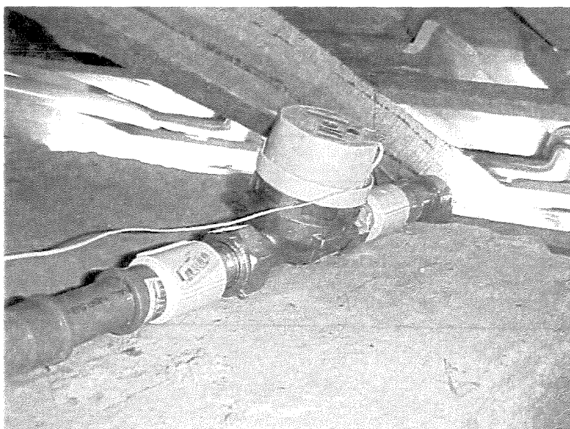
Figura 4.14 Detalhe da instalação do hidrômetro eletrônico para a medição do consumo geral da residência.
