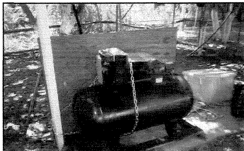
Figura 4.16: Compressor utilizado para o sistema de aeração
