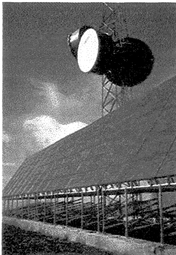
Figura 16 - Painéis fotovoltaicos alimentando torre de telecomunicações
