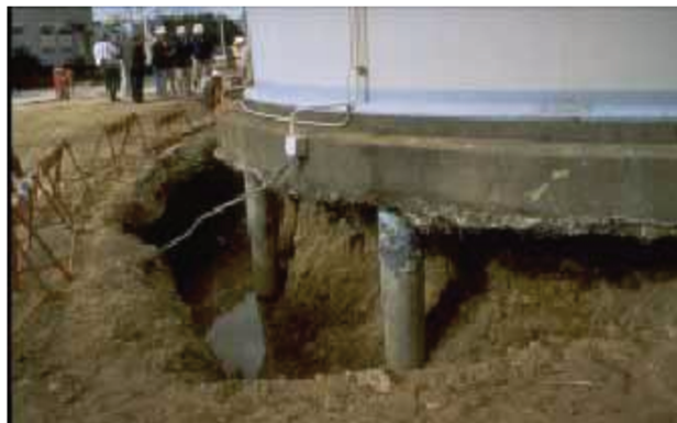
Figura 3.80: Falha da fundação por liquefação (EERC, U. C. Berkeley)
