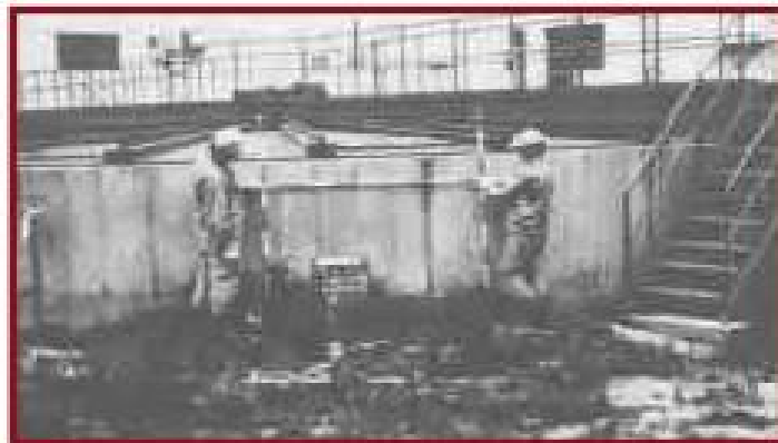
Figura 1.2: Reservatório de águas residuais afetado pela liquefação em Japão
