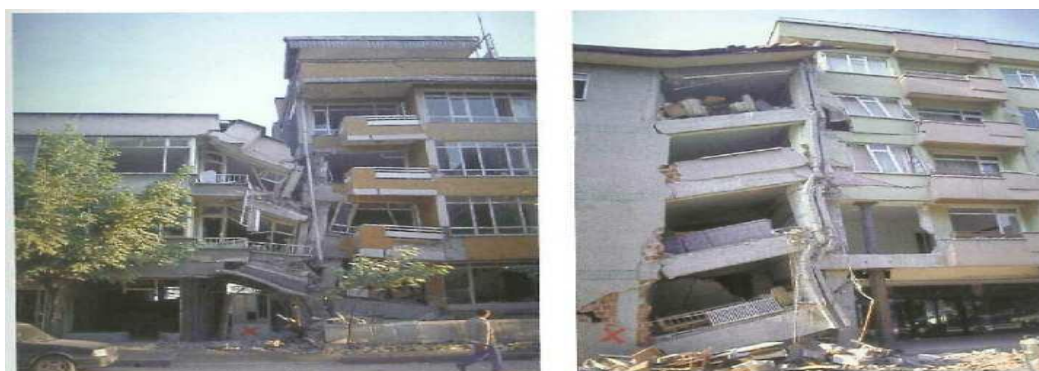
Figura 2.15: Prédios vizinhos sujeitos ao martelamento (LESTUZZI, 2008)
