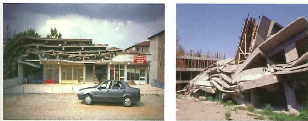
Figura 2.11: Colapso em bloco (LESTUZZI, 2008)
