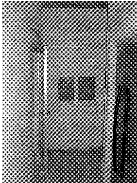
Figura 22- Localização dos quadros de distribuição no Bloco 2 – caixa de escada de serviços
