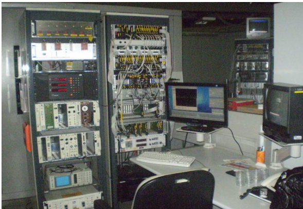
c) Vista geral do painel de controle
