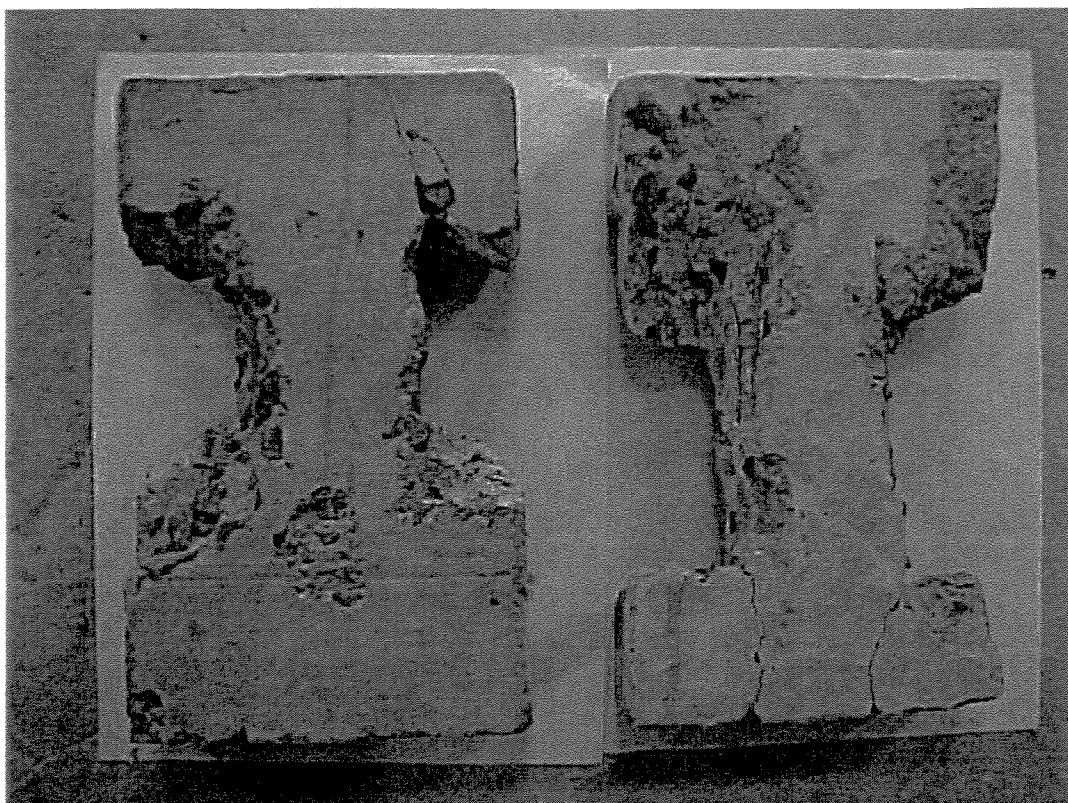
FIGURA B.6 – Arrancamento do concreto na região do conector metálico
