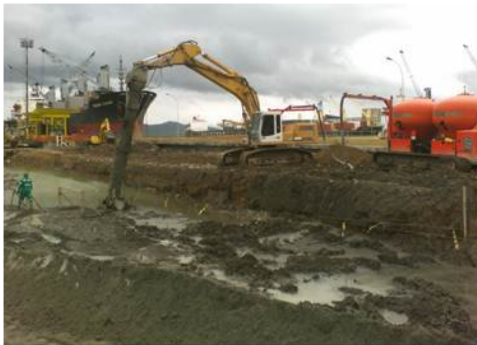
Figura 3.9 – Vista da obra em São Francisco do Sul – SC Fonte: (arquivo pessoal)
