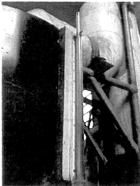
Figura 5.10 – Medidor de nível instalado no tanque volumétrico
