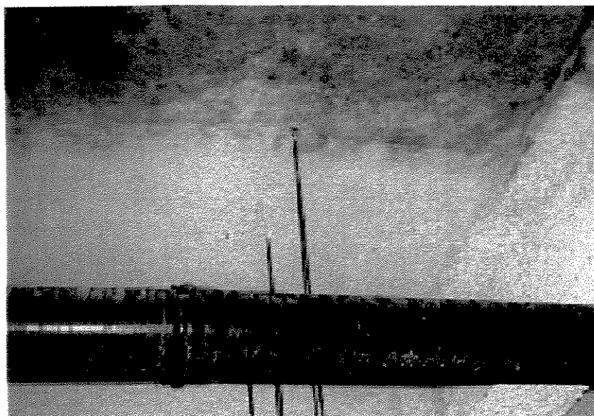
Figura 3.8 – Umidade de condensação no teto da pista de gelo
