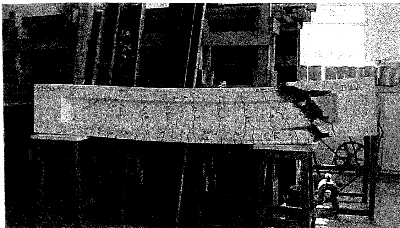
Figura 4.27 – Configuração final das fissuras - Viga I – 143 A.
