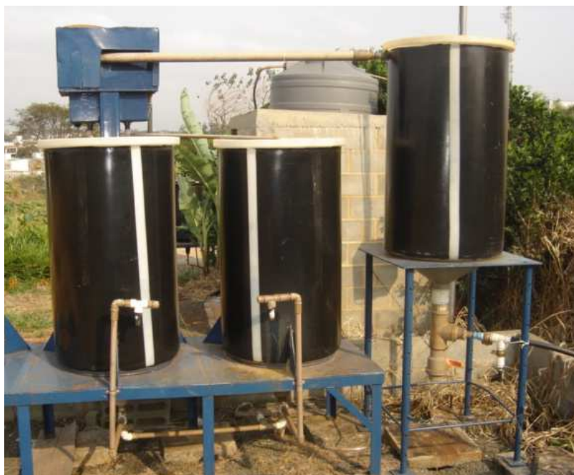
Figura 63 Vista geral dos filtros recobertos por lonas pretas
