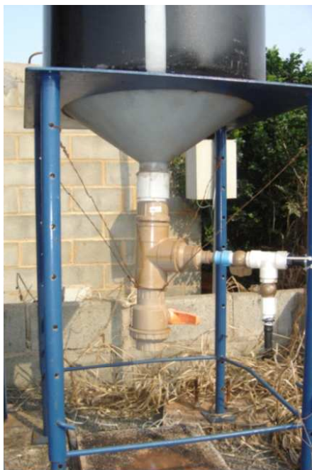
Figura 68 Válvula de descarga de fundo do pré-filtro de pedregulho
