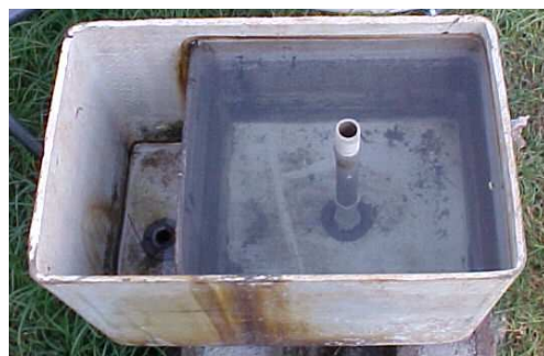
Figura 25 Foto do dosador do Pré-filtro de Pedregulho
