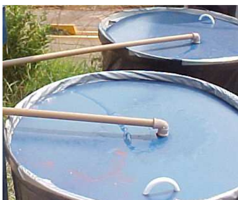
Figura 64 Tampas dos filtros lentos
