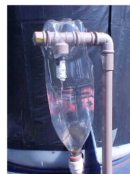
Figura 32 Foto sistema de coleta do efluente dos filtros lentos
