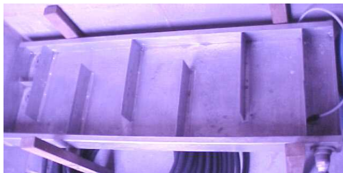
Figura 36 Foto da caixa de contato usada na desinfecção com hipoclorito de sódio (PIRES, 2002)
