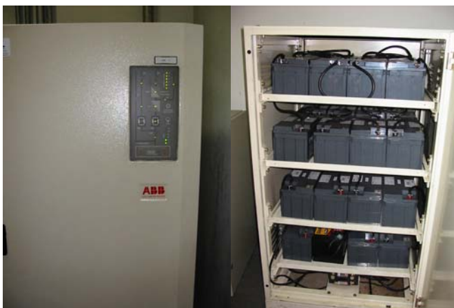
Figura 5.1.2.7 – Sistema de nobrake que alimenta os caixas registradores
