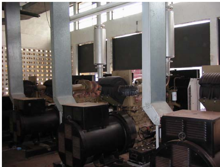
Figura 5.1.2.3 – Grupo gerador à diesel com 4x 250 kVA
