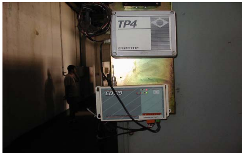
Figura 5.1.2.4 – Sistema de Medição Remota no quadro de energia principal
