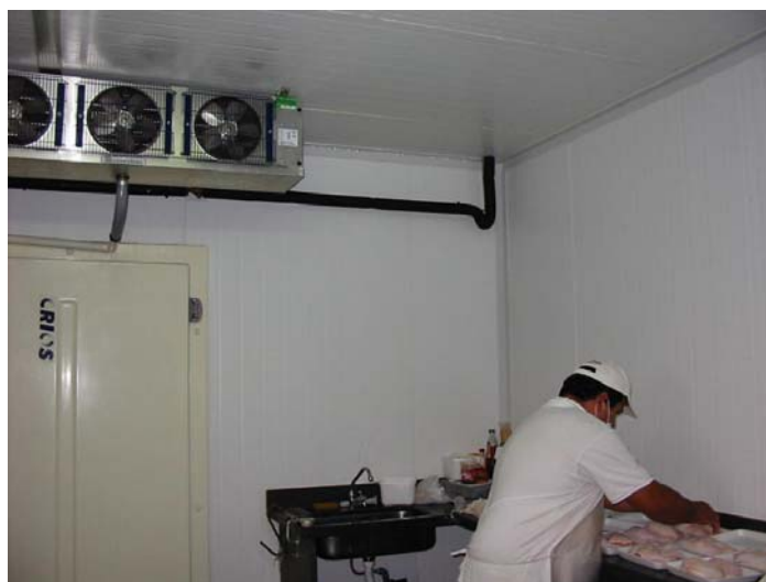
Figura 5.2.3– Área refrigerada de preparação de alimentos para venda
