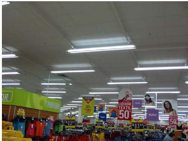
Figura 5.4.1– Iluminação artificial calha com lâmpadas fluorescentes
