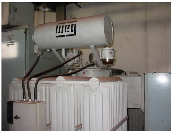
Foto 5.1.2.1 - Transformador Principal I - 1000 kVA
