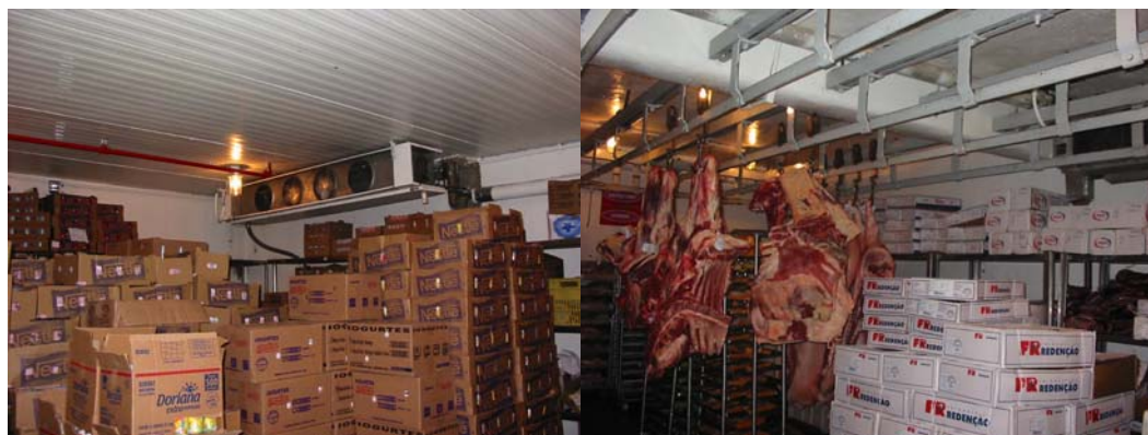
Figura 5.2.1.3 – Câmara fria para armazenamento de alimentos congelados
