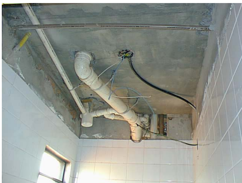
Figura 3.22 – Shaft para instalações hidráulicas.
