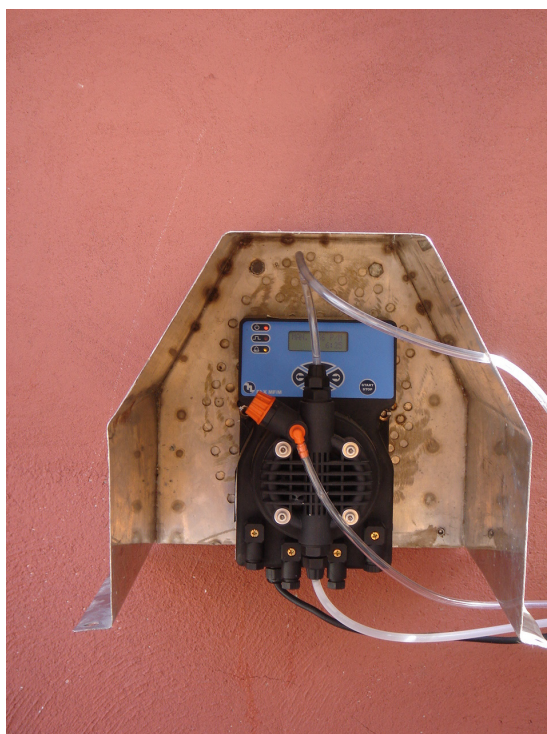
Figura 4.40 – VISTA DA BOMBA DOSADORA DA SOLUÇÃO DE PAC Fonte: MENDES (2006)
