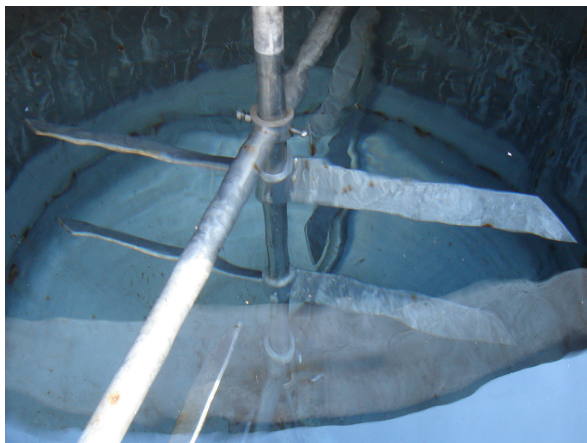
Figura 4.41 – VISTA DE DETALHE INTERNO DO FLOCULADOR MECÂNICO E TURBINA Fonte: MENDES (2006)
