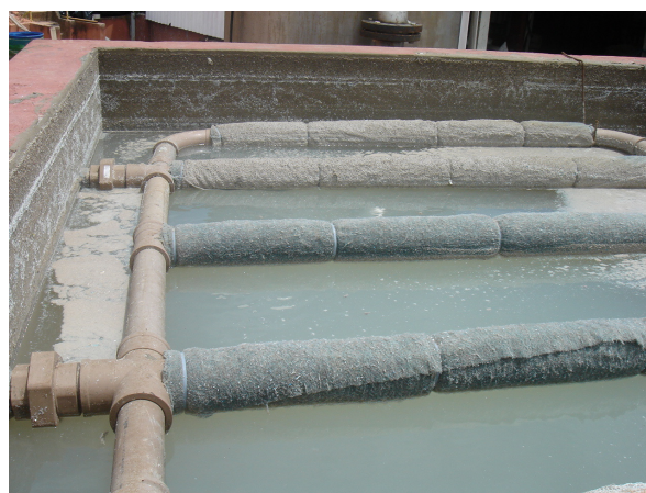
Figura 4.44: MANIFOLD / FILTRO DE COLETA DE EFLUENTE CLARIFICADO, PROVIDO DE CINCO TRECHOS DE TUBULAÇÃO REVESTIDOS COM MANTAS Fonte: MENDES (2006)
