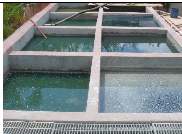
Figura 4.47: VISTA DOS LEITOS DE SECAGEM EM FASE INICIAL DE OPERAÇÃO Fonte: MENDES (2006)
