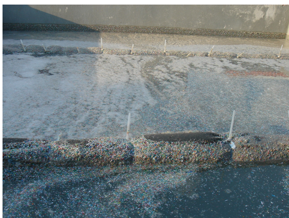
Figura 4.50: PRESENÇA EXCESSIVA DE SÓLIDOS GROSSEIROS NO FILTRO COLETOR DE ÁGUA DECANTADA Fonte: MENDES (2006)
