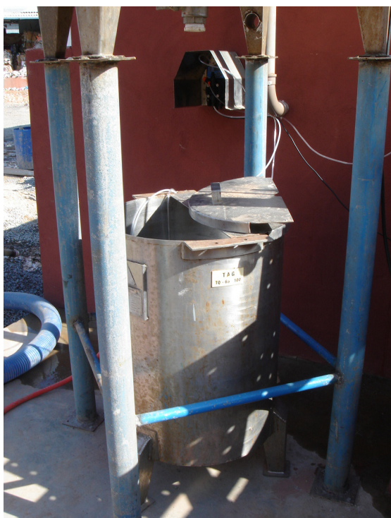
Figura 4.39 – VISTA DO TANQUE DE PREPARAÇÃO DA SOLUÇÃO DILUÍDA DE PAC (1:3, NA INAUGURAÇÃO, HOJE, TAL QUAL) Fonte: MENDES (2006)
