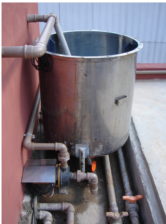
Figura 4.45: CÂMARA CILÍNDRICA DE RECEBIMENTO DO EFLUENTE CLARIFICADO PARA POSTERIOR RECALQUE AO RESERVATÓRIO DE ÁGUA PARA REÚSO
