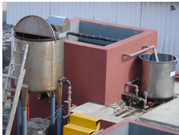
Figura 4.42 – VISTA DAS UNIDADES DE FLOCULAÇÃO, DECANTAÇÃO E DE RECEPÇÃO DE EFLUENTE TRATADO Fonte: MENDES (2006)
