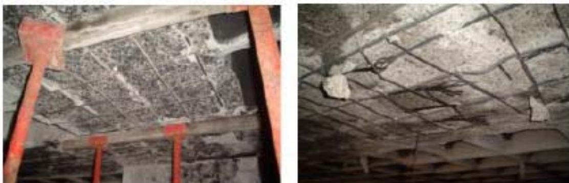
Figura 5.2 – Lascamentos provocaram a destruição do cobrimento da laje em edifício de Recife (OLIVEIRA, 2006).
