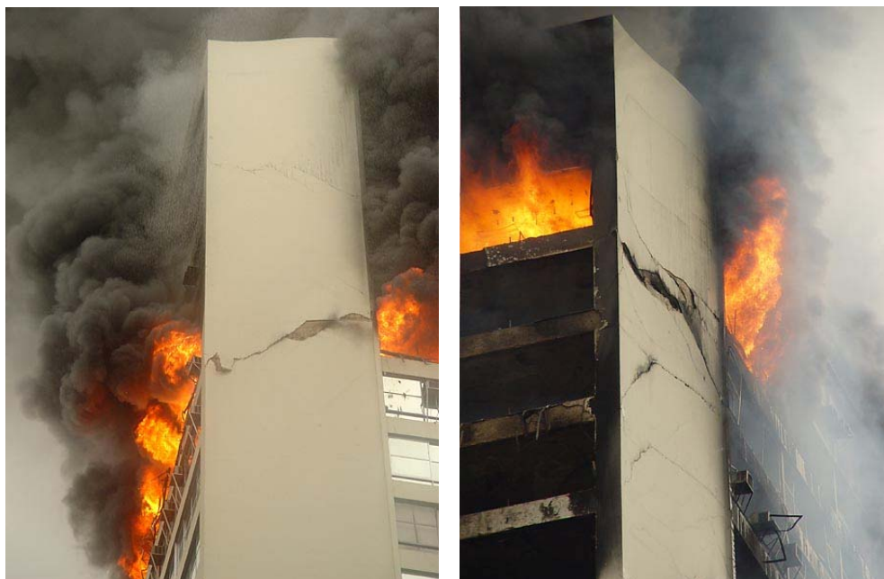
Figura 1.4 - Edifício Herm Stoltz da Eletrobrás – Rio de Janeiro – colapso parcial, 2004 ( Fonte: Engº. Wilian César Aguiar apud COSTA, 2008 ).
