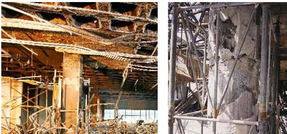
Figura 5.1 – Vista interna do aeroporto e de um pilar com colapso parcial e lascamento do cobrimento (COSTA, 2008).
