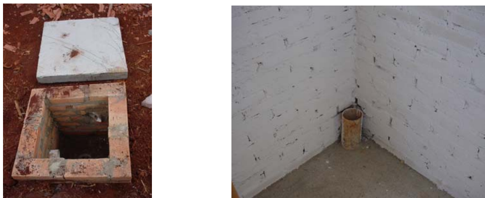
FIGURA 99 – Caixa e tubulação de passagem dos termopares (agosto/2003)
