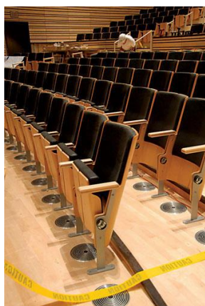
(a) Ventilação sob as poltronas.
