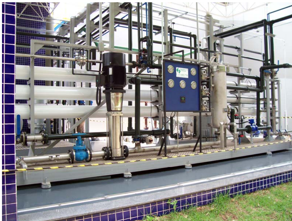
Figura 4.17 - Sistema de Osmose Reversa
