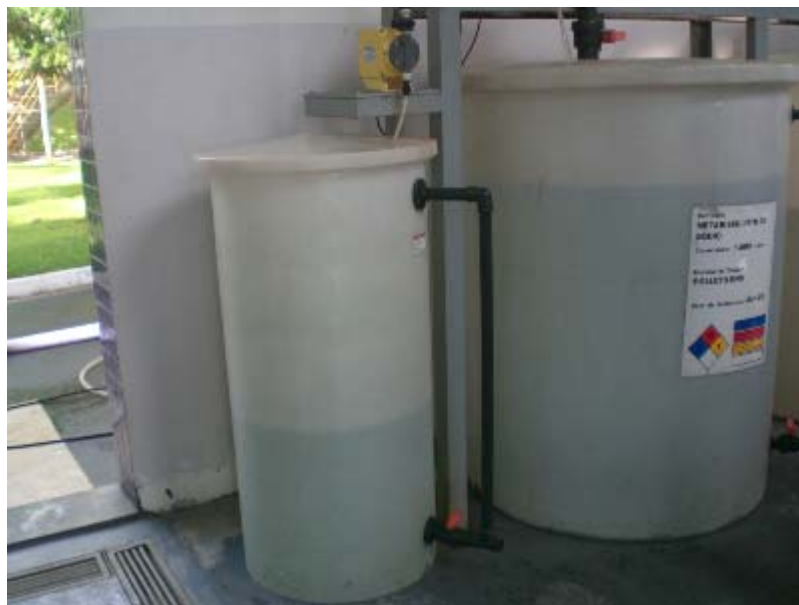
Figura 4.18 - Tanque de dosagem de anti-incrustante e metabissulfito de sódio respectivamente.
