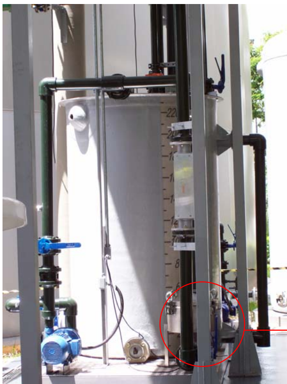
Fig. 4.19 - Tanque de preparo de soluções para limpeza química
