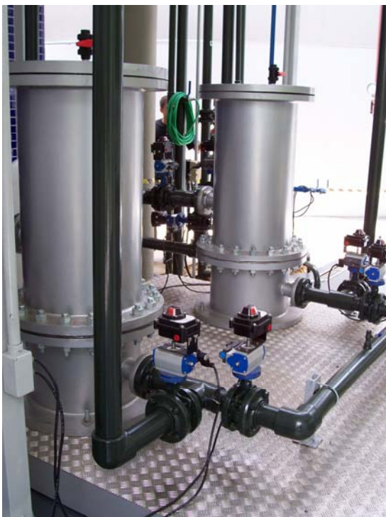
Fig. 4.11 - cilindros de aço vertical
