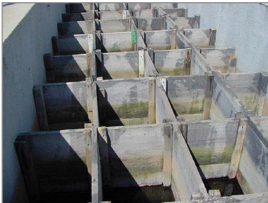
FIGURA 3.4 - Floculador hidráulico da ETA São Silvestre
