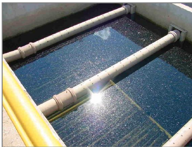
FIGURA 3.5 - Tubos coletores de água decantada da ETA São Silvestre, podendo-se visualizar abaixo da linha d'água os módulos tubulares
