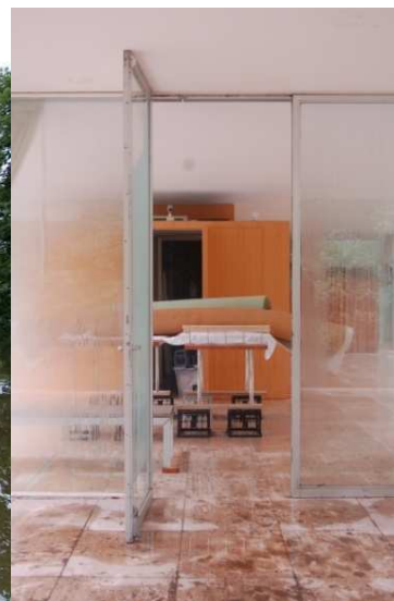
Figura 30. Casa Farnsworth: imagem interna após inundação em setembro de 2008
