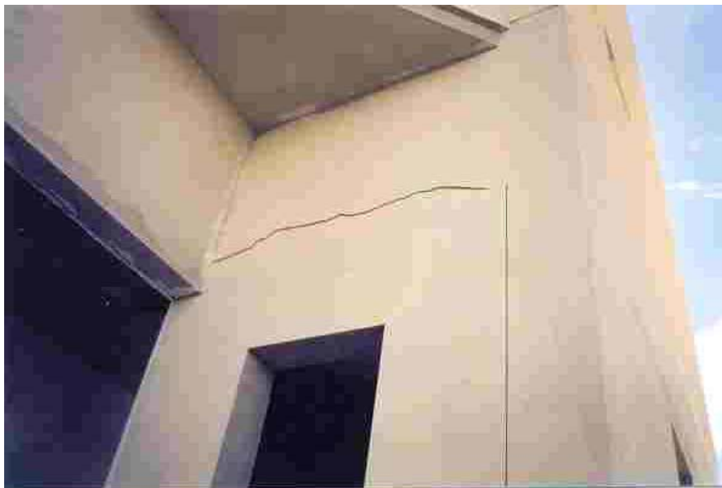
Figura 2.22 – Fissuras na Interface Alvenaria de Vedação–Estrutura de Concreto.
