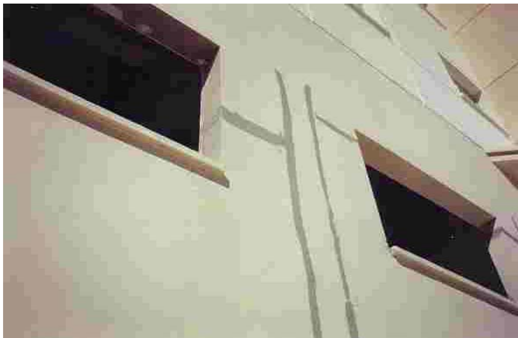
Figura 2.25 – Fissuras na Interface Alvenaria Externa de Vedação–Estrutura de Concreto.
