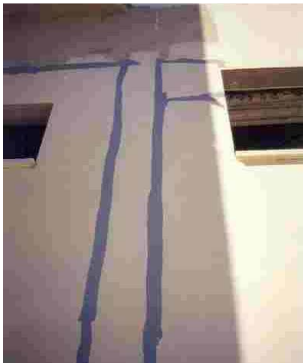
Figura 2.26 – Fissuras na Interface Alvenaria Externa de Vedação–Estrutura de Concreto.
