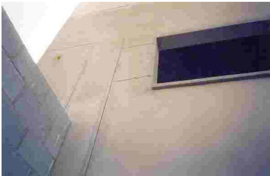
Figura 2.24 – Fissuras na Interface Alvenaria de Vedação–Estrutura de Concreto.
