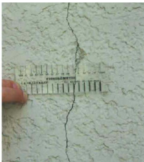
Figura 2.27 – Fissuras na Alvenaria Interna de Vedação (Medeiros e Franco, 1999).
