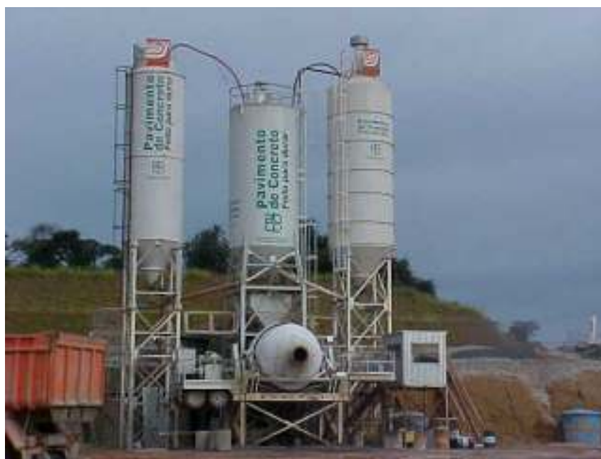
Figura 2 - Central de concreto
