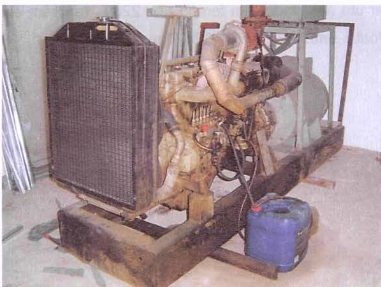
Figura 7-8 . Gerador de energia a diesel de 60 KVA da Rental Center Utilizado neste trabalho como fonte de ruído.
