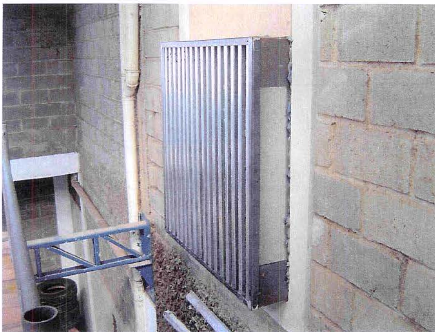
Figura 7-6. Vista do galpão onde foram realizadas as medidas de perda de Transmissão e Perda por inserção. Atenuador foi instalado a 05 m de altura.
