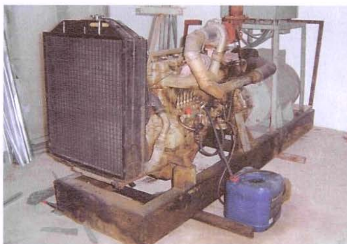
Foto 2 .Grupo Gerador de 60 KVA instalado dentro da sala de teste
