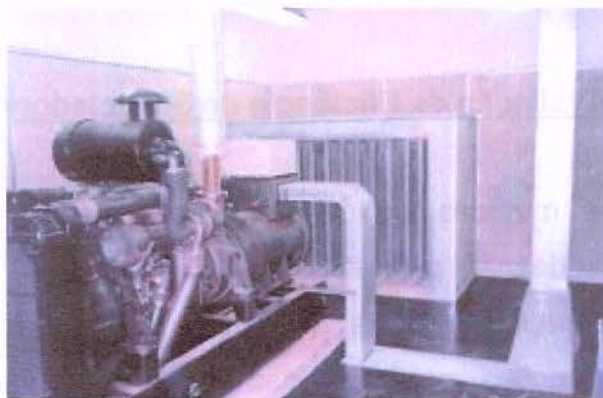
Figura 7-1. Sala de alvenaria com grupo gerador instalado, ao fundo silenciador de ruído com lamelas na entrada de ar (FONTE: Acustecni, 2003)
