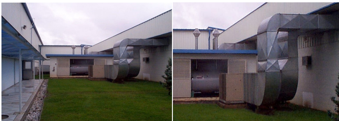
FIGURA 4.20 – Utilização de central geral de utilidades com grupos de máquinas de pequeno porte
