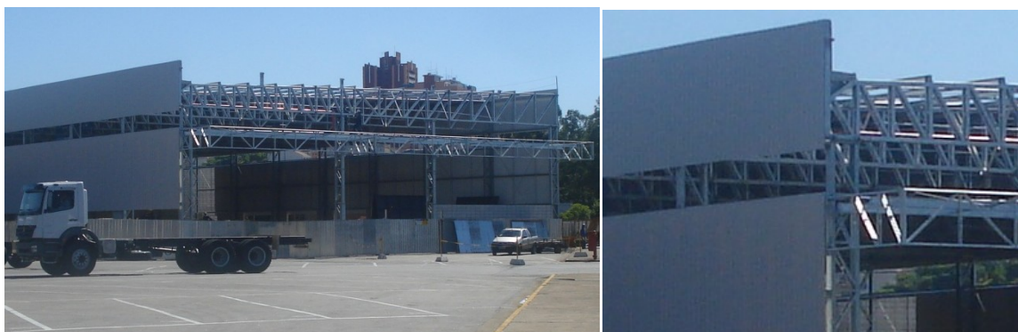
FIGURA 4.10– Utilização de fechamento com painéis metálicos termo acústicos
