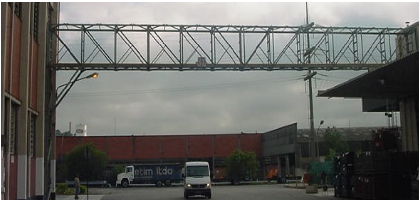
FIGURA 4.24 – Utilização de tubulação de distribuição primária sobre pipe rack
