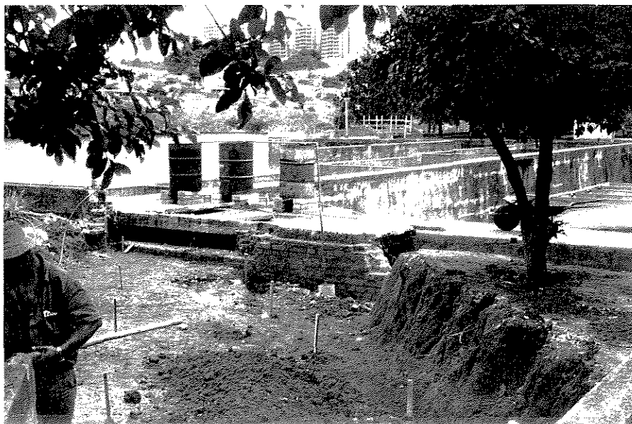
FIGURA 10 - Rompimento do emissário de esgoto à estação depuradora do Cambuí
