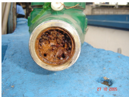
vista do filtro de entrada
