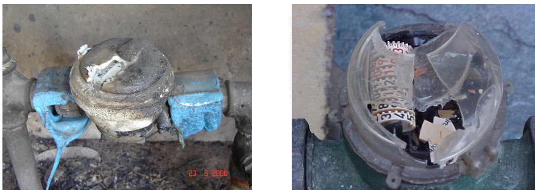
Figura 3.10 – Hidrômetros com ocorrência de vandalismo.
