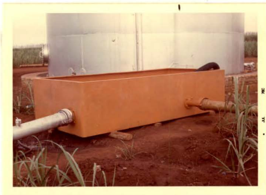
FIGURA 8. Caixa distribuidora de 3.500 litros para estabilizar a carga hidráulica e distribuir a água.
