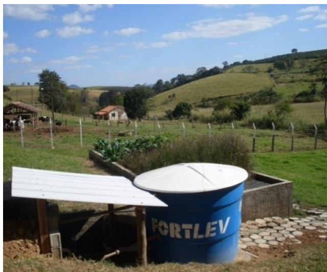
Figura 34 - Tanque de equalização.
