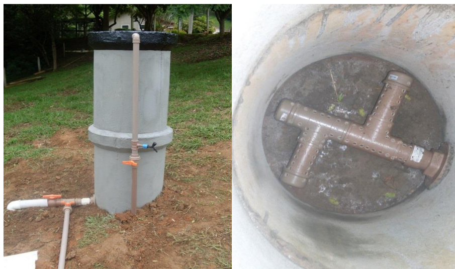
Figura 40 - Vista lateral do filtro de seixo e do encanamento de fundo da unidade.
