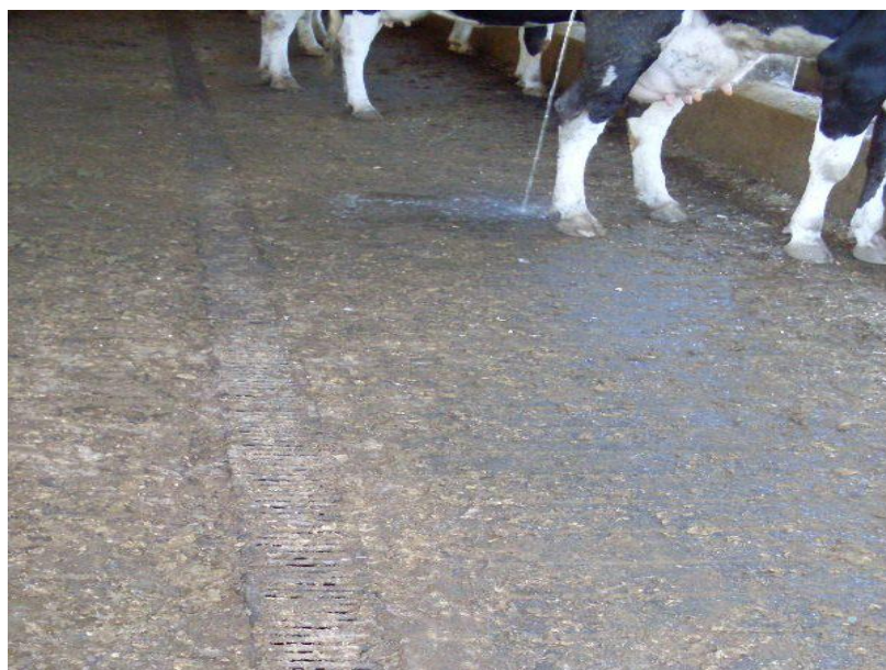
Figura 18 - Grelha de ferro que protege a canaleta coletora do efluente bruto do “free-stall”.
