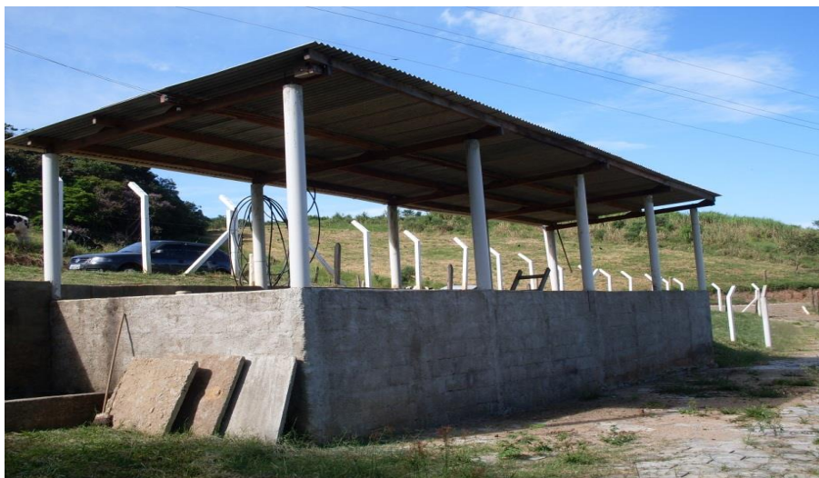
Figura 23 - 1ª Unidade - Vista geral das Caixas de Retenção da ETE.
