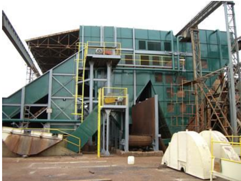
Figura 18: Sistema de Limpeza – Usina Guaíra.
