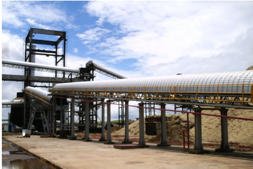
Figura 21: Transportadores condutores de palha por todo processo.
