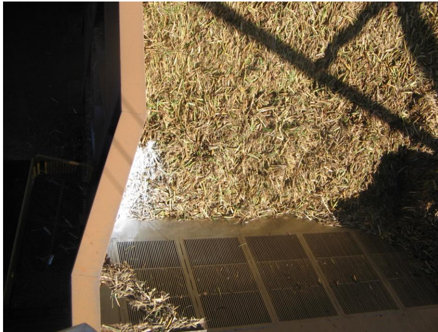
Figura 15: Grelha da mesa alimentadora – Usina Cerradinho.
