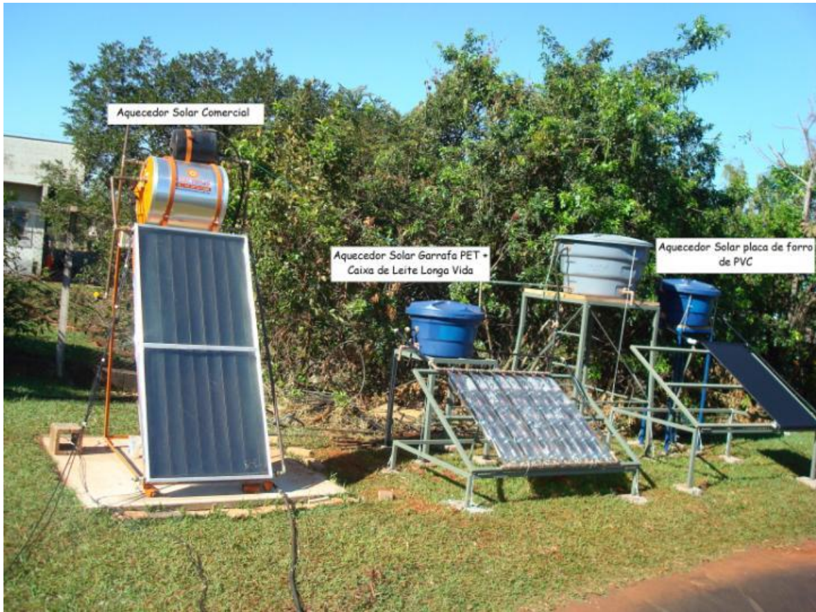
Figura 4: Equipamentos instalados para desenvolvimento da técnica SOPAS no Campo experimental
