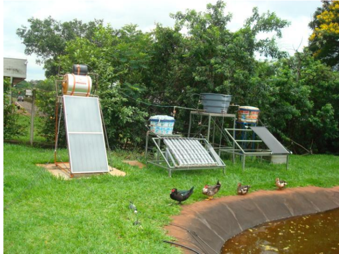
Figura 20: Caixas dos Reservatórios com revestimento Térmico
