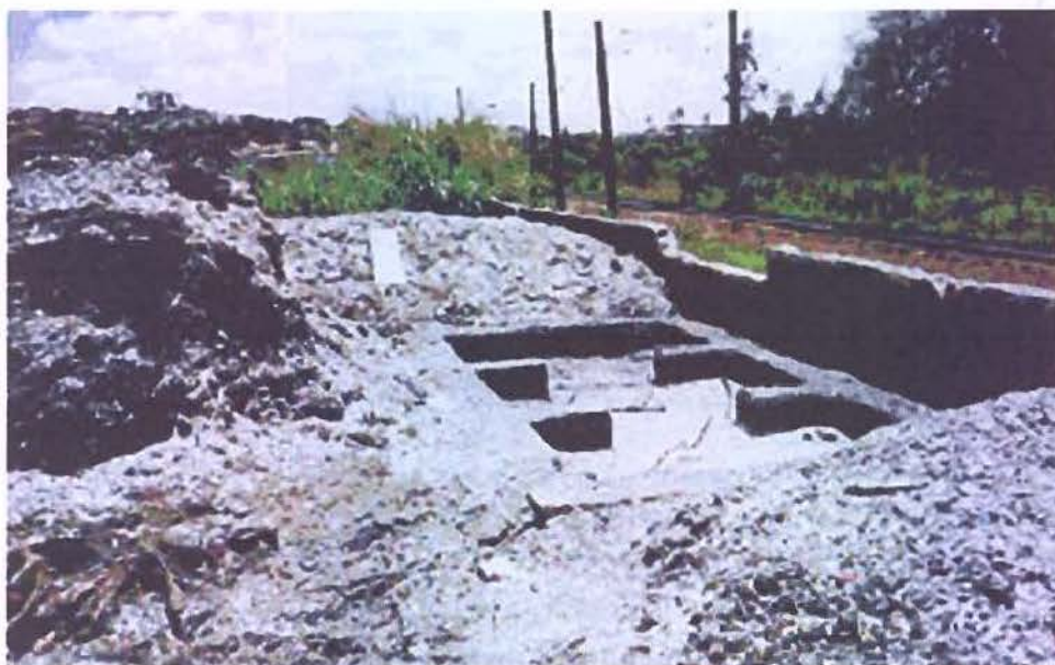
Figura 37 Tanque chicanado para sedimentação de resíduos (primeiro tanque) tendo ao redor resíduos da sedimentação para secagem
