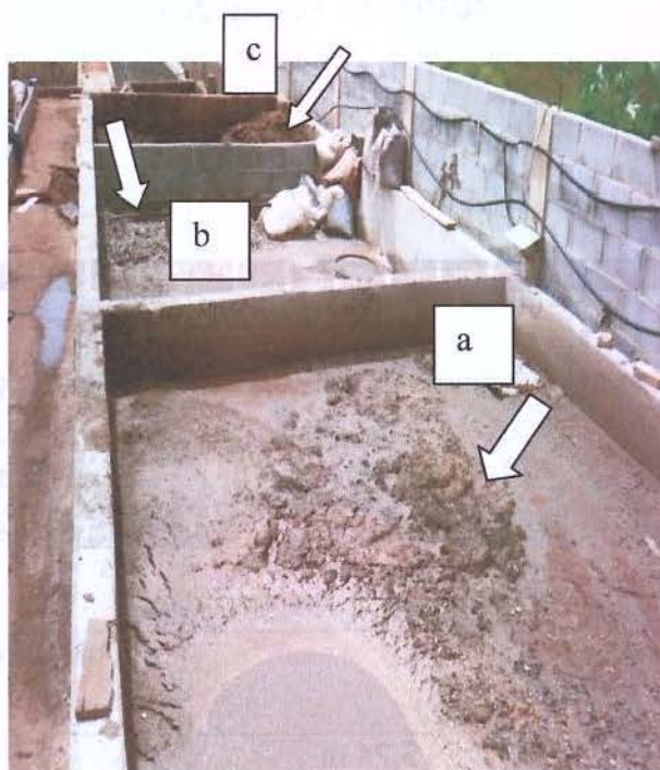
Figura 69 Leito de secagem com os 3 compartimentos em operação: 1) compartimento a 2) compartimento b 3) compartimento c
