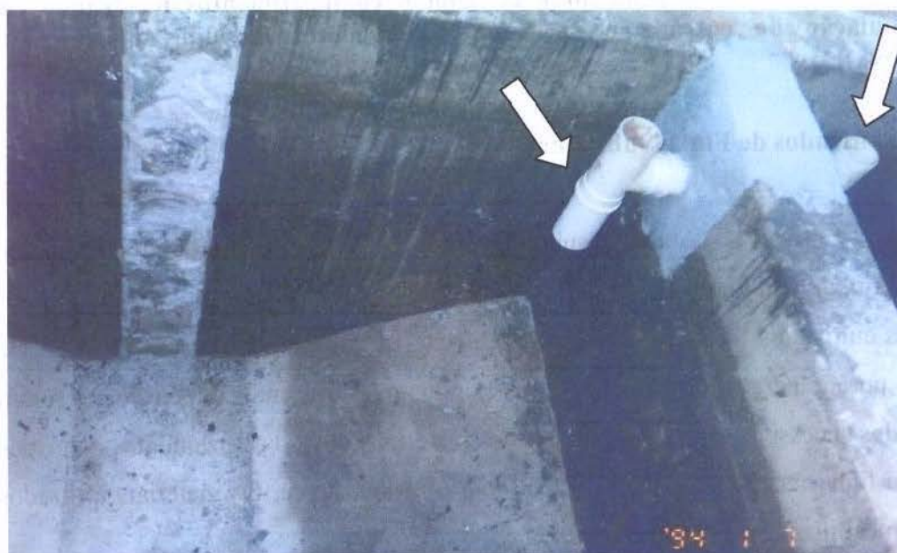
Figura 53 Tubulação de saída e de entrada nos compartimentos do RAC
