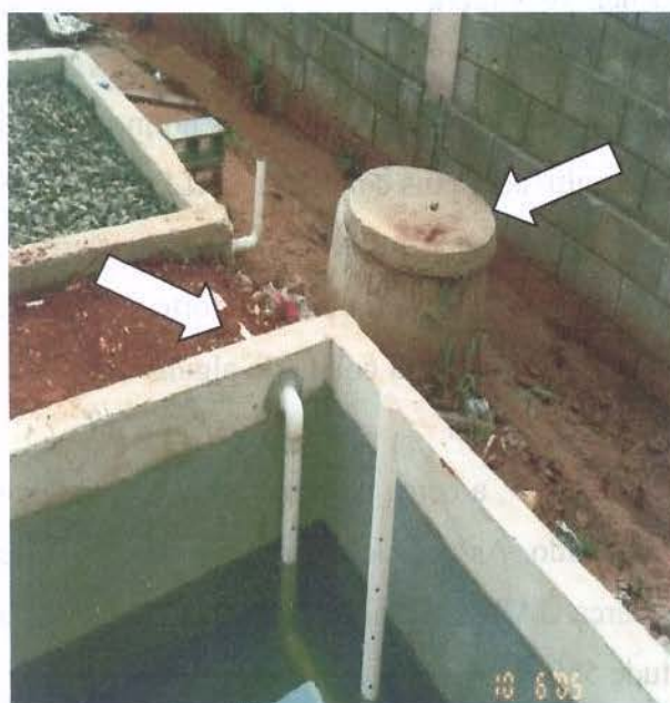
Figura 61 Tubulação de saída do primeiro leito cultivado e coletor público de esgoto
