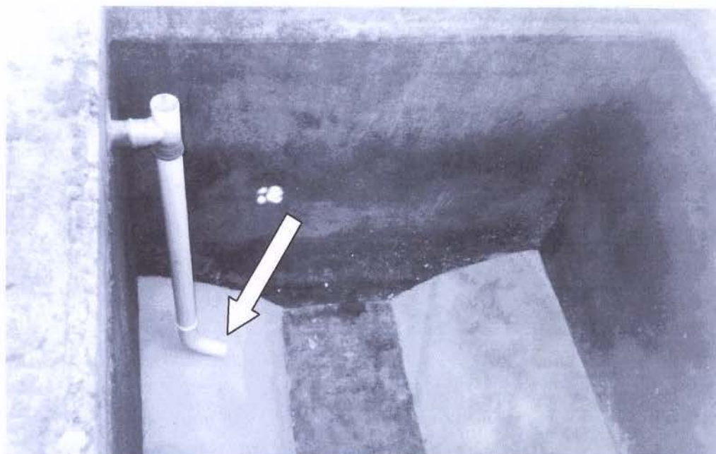
Figura 52 Tubulação de entrada em compartimento do RAC e detalhe do fundo em forma de “U”
