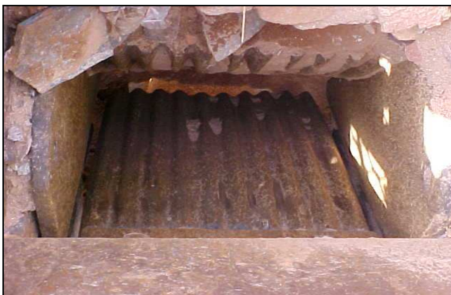
Figura 33B. Abertura da câmara (boca) do britador de mandíbulas, da usina de Vinhedo.
