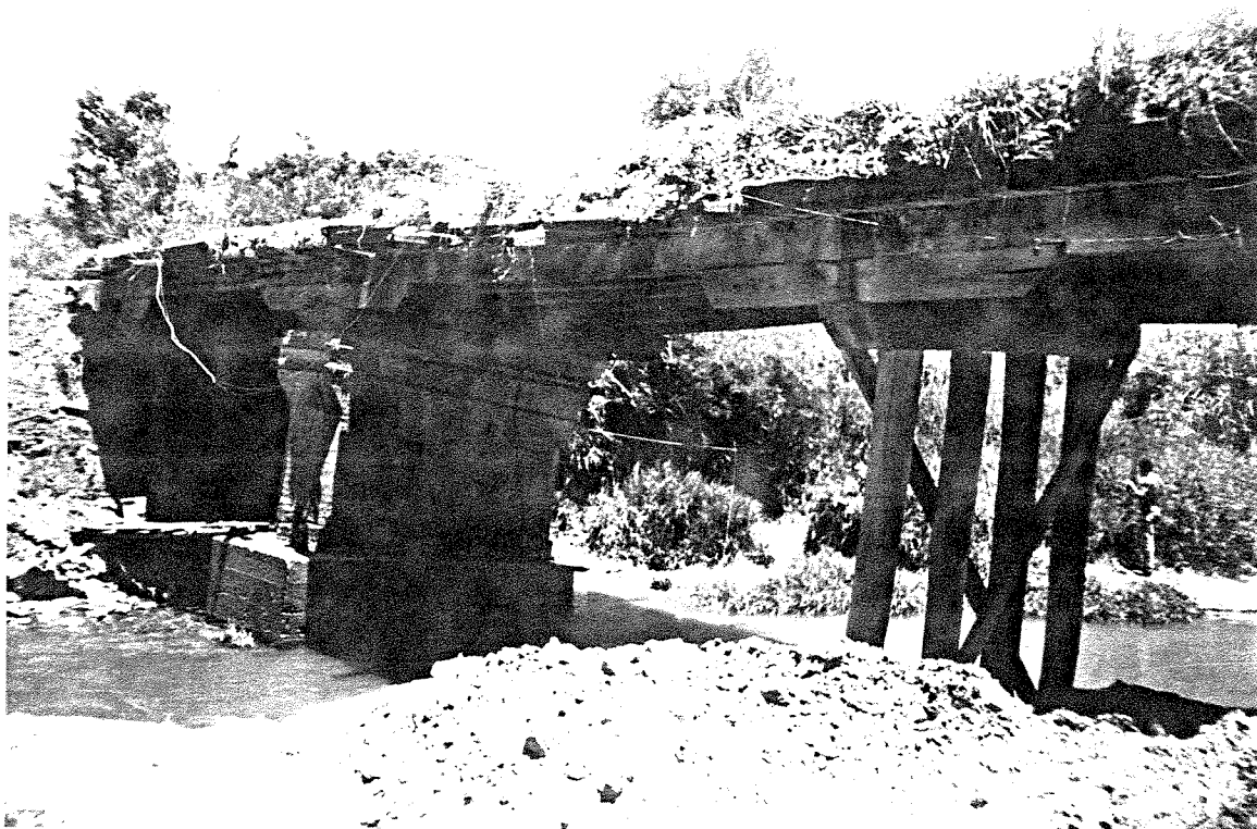
Foto 4 – Detalhe de recalque de pilar de alvenaria em ponte de madeira
