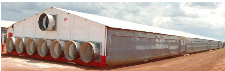
Figura 6. Sistema de ventilação utilizando exaustores.
