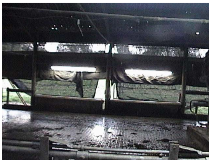
Figura 41. Imagem da iluminação artificial na linha dos bebedouros.
