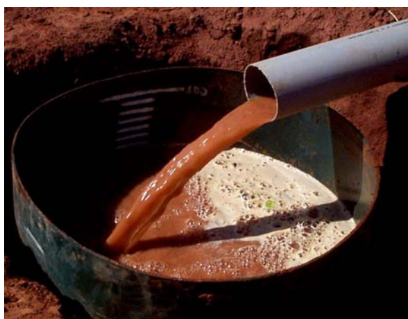
Figura 7: Reservatório para coleta de água no canal secundário.
