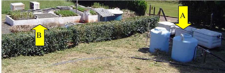
Figura 7 Vista parcial do sistema com os tanques sépticos compartimentados (A) e leitos cultivados ao fundo (B).
